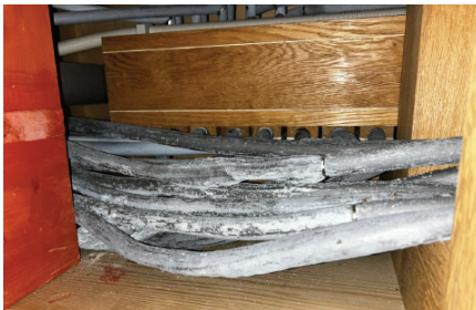
Korrosive Umweltgase gefährden und zerstören die Bleikondenkten.
